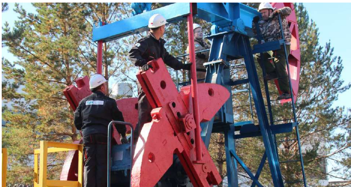
Станок-качалка на испытательном полигоне, производственная площадка ТИК-3
