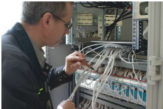
Сборка и настройка шкафа системы ТИК-RVM
