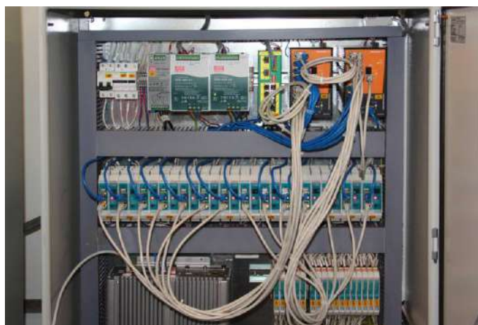
Шкаф системы АСУТП
