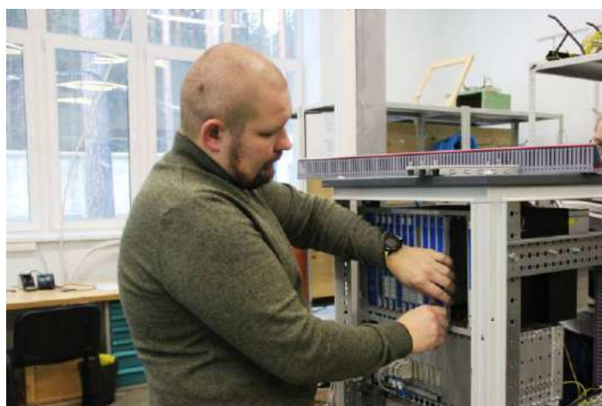
Сборка и настройка шкафа системы ТИК-RVM
